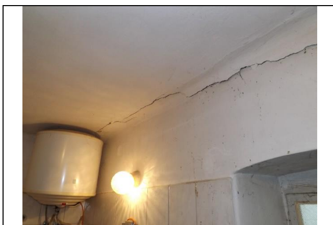
repedés a falon
